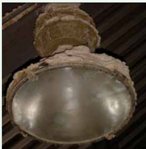
Acúmulo de pó em equipamento elétrico
